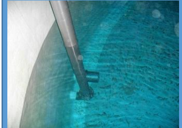
Cuve d'eau potable du réservoir Bretagne – commune de Romagne
