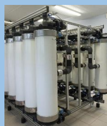
Membranes ultra-filtrantes – Usine de Destilles
