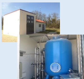
Usine de traitement par charbon actif construite sur le site du forage de la Poisnière
