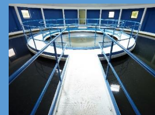
Bassin de décantation – usine d'eau potable Jules Duvau - Châtellerault
