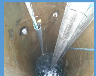
Intérieur d'un forage
