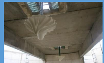
Turbines - bassin d'aération de la station d'épuration de Dienné
