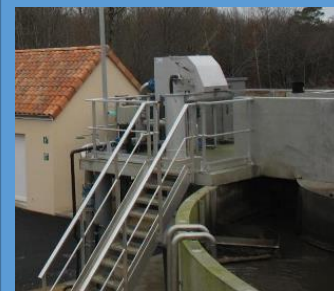
Tamis rotatif – Station d'épuration de Verrières
