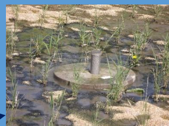
Cheminée d'alimentation et plaque anti-affoulement – STEP de Queaux
