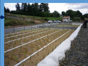
Tuyaux aériens sur sable – Step FPR La Chapelle Moulière
