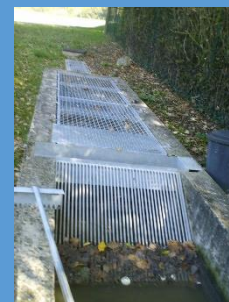
Dégrilleur – Step Angles sur Anglin
