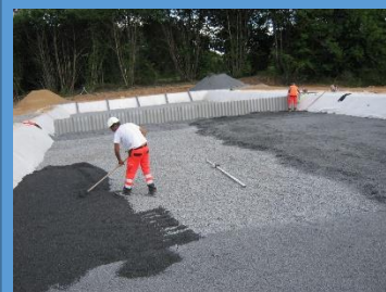
Pose des graviers au 1 er étage – Steps FPR de Sommières du Clain et de Romagne
