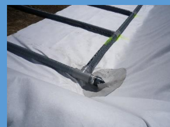
Tuyaux de drainage – STEP de la Chapelle Moulière.
